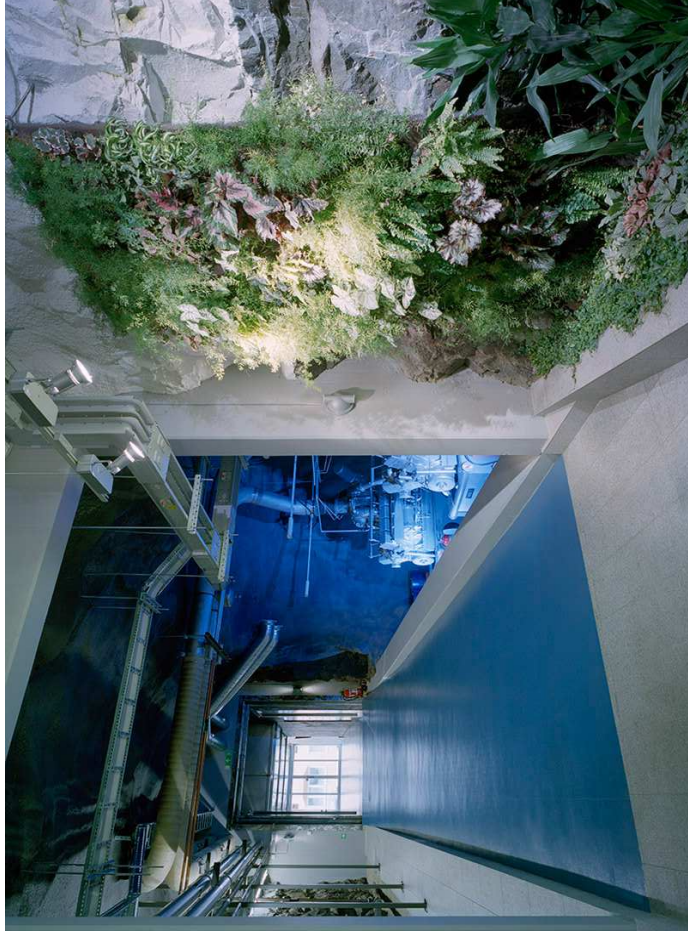
Albert France-Lanord. Pionen Data Center
