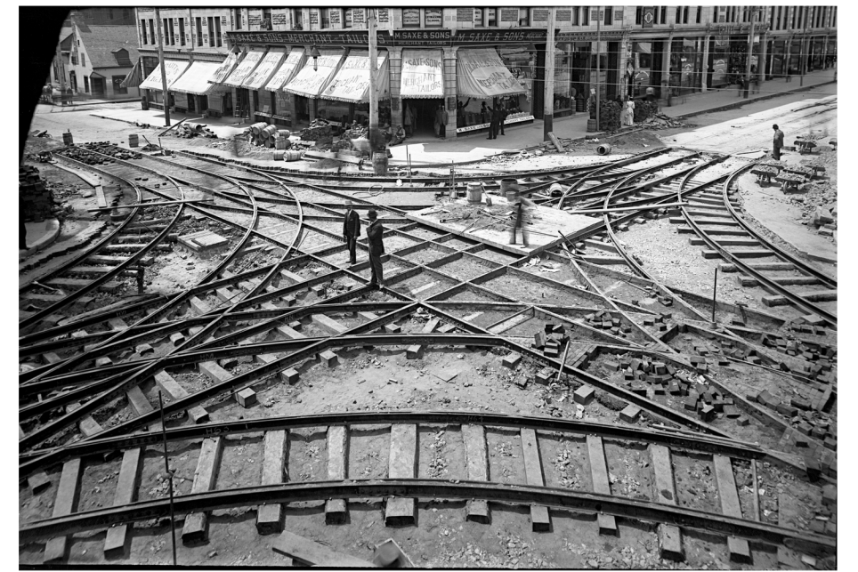
Passage à niveau de tramway en construction, rues Sainte-Catherine et Saint-Laurent, Montréal. William Notman & Son, 1893
