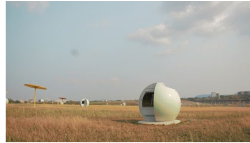
© Geneviève Dorval-Douville (boîtier de puits de captage de biogaz )
