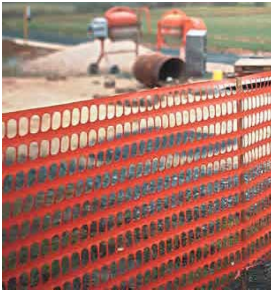
Barrières en grillage de plastique
